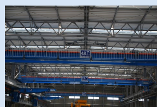
天井クレーン
